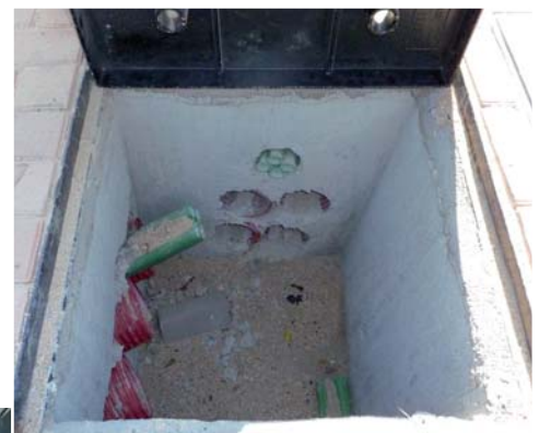
Soterrado infraestructura eléctrica >>
